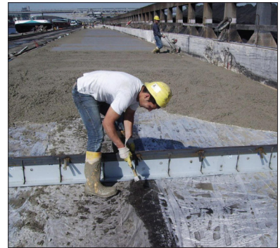
Kohlelager VÖST Alpine recostal® Trennfugenelement mit Profilaufnahme
